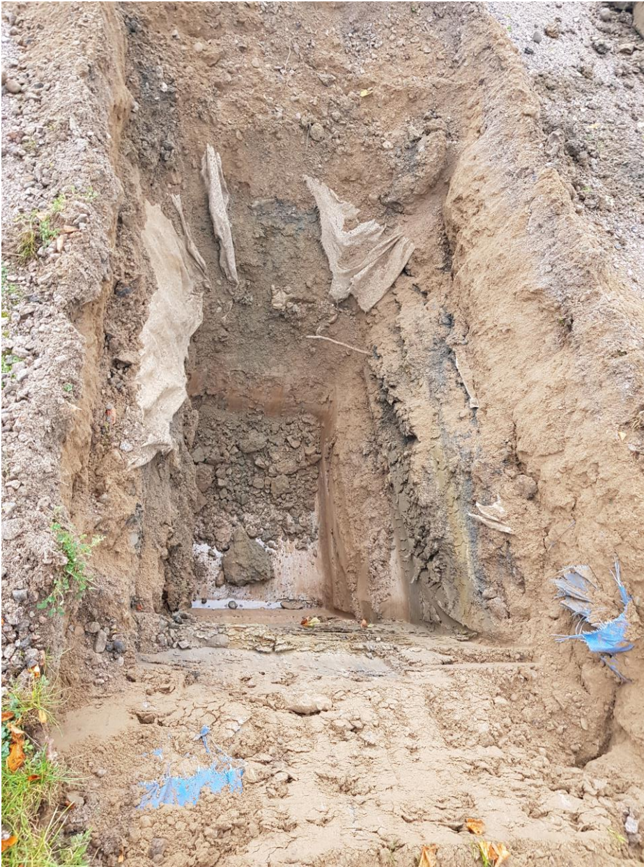
Figur 4. Schaktgrop i provpunkt 21SW06 0,0-2,0 m. Vid 0,5 m syns en vit och en blå markduk.
