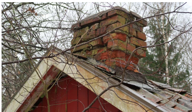
Brygghusets skorsten med frostsador.
