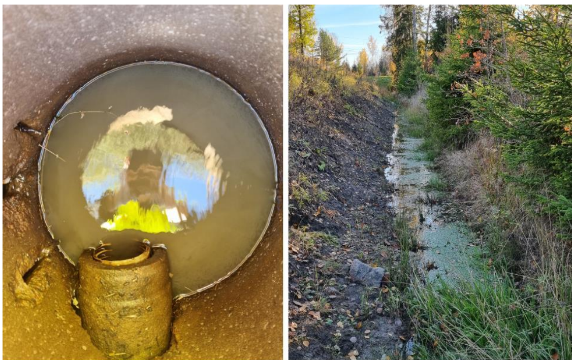
Figur 11. Till vänster: Inlopp på åkerdräneringens första sträckning (Sträcka A-B). Inlopp med diametern 90 mm, betongledning. Till höger: inmätt dike nedströms dit åkerdräneringen mynnar genom Trumma 3, precis innan inloppet mot Trumma 2.
