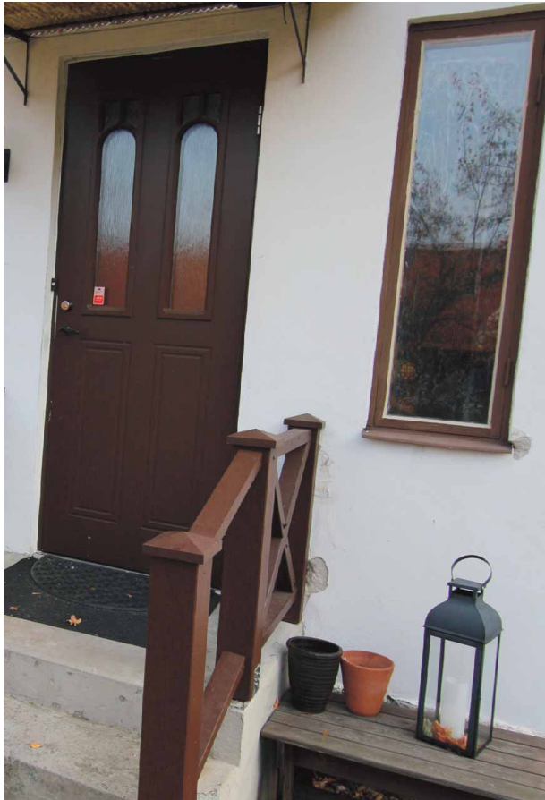
Entréddörr mot väst, bytt under 2000-tal. Puts spricker i anslutning till räcketts infästning i fasad.
