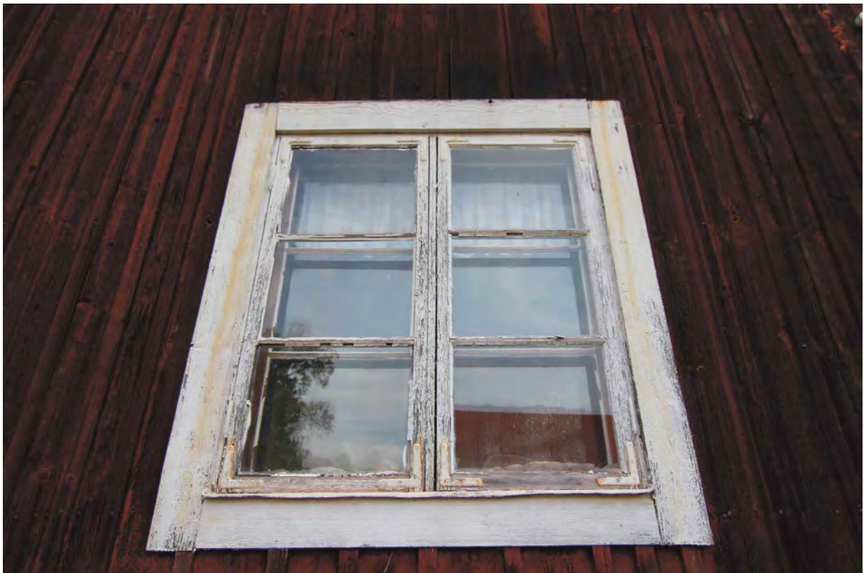
Byggnaden har tvåluftsfönster utan kopplade bågar. Dessa är i behov av underhåll och målning, men är generellt i acceptabelt skick.
