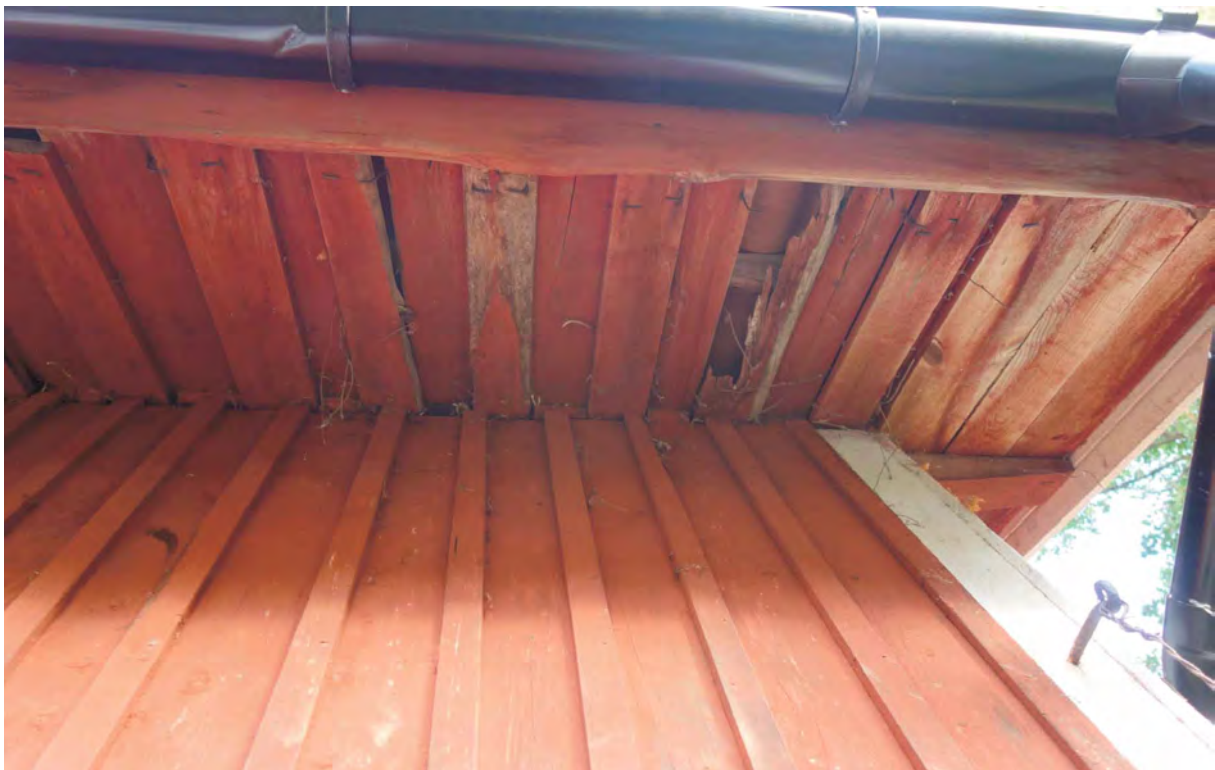
Underlagstak har vissa skador, men taket bedöms ändå vara tätt då det är renoverat relativt nyligen.
