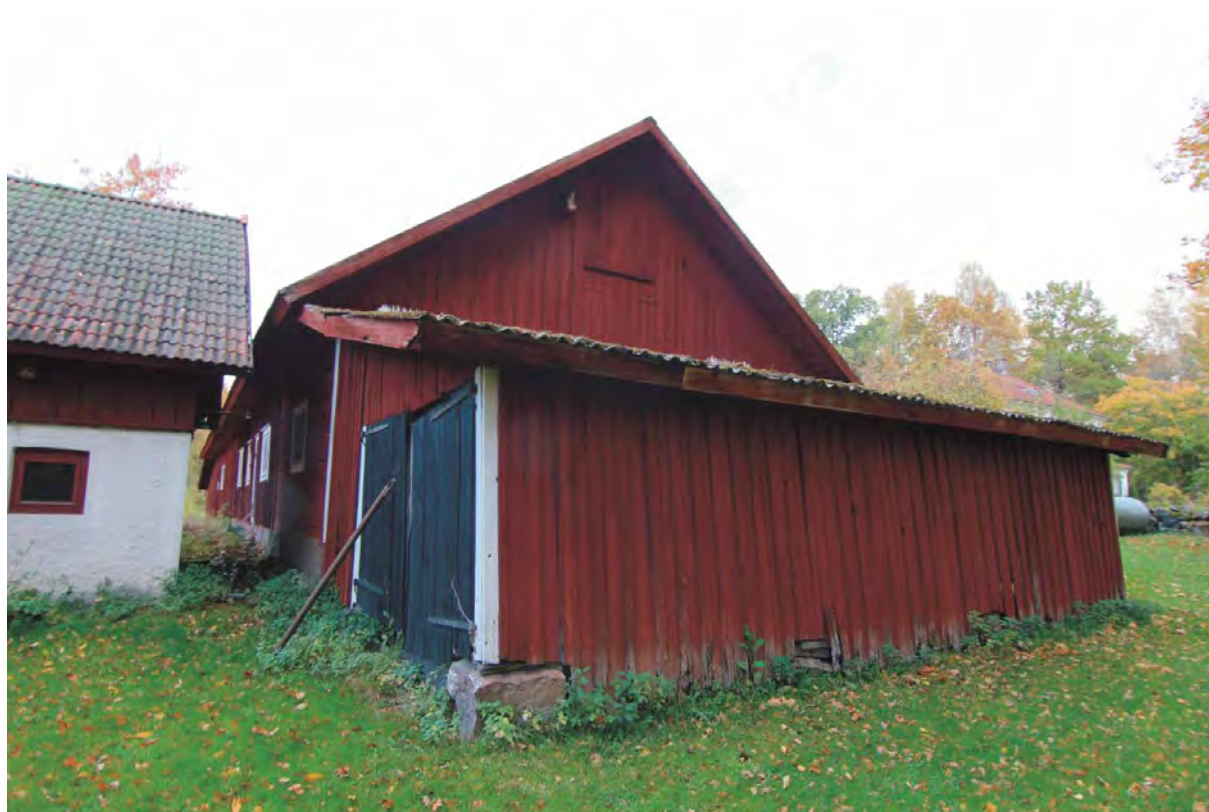
Ladugårdens södra del med eternittak. Takets vindskena mot väst är i dåligt skick.
