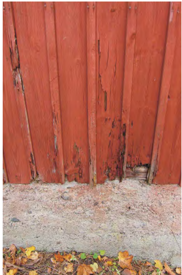
Rötskada i panel.
