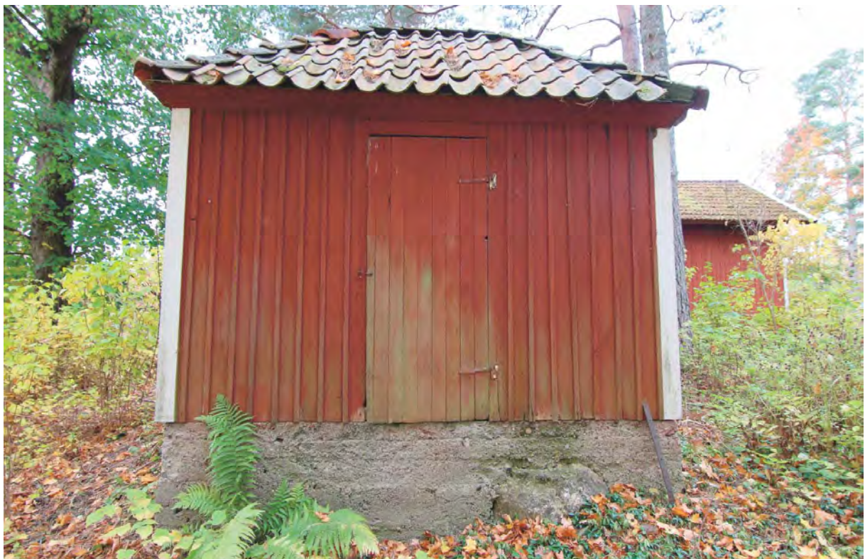
Fasad mot öst. Panelen har viss algpåväxt.
