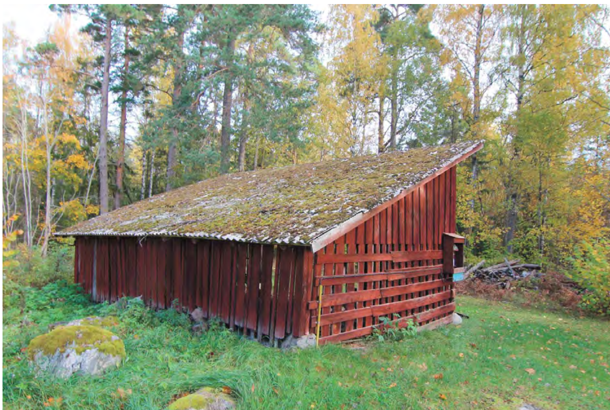
Vedförrådet sett från sydväst. Gles panel för luftning och pulpettak av eternit. Taket är påväxt av mossa.
