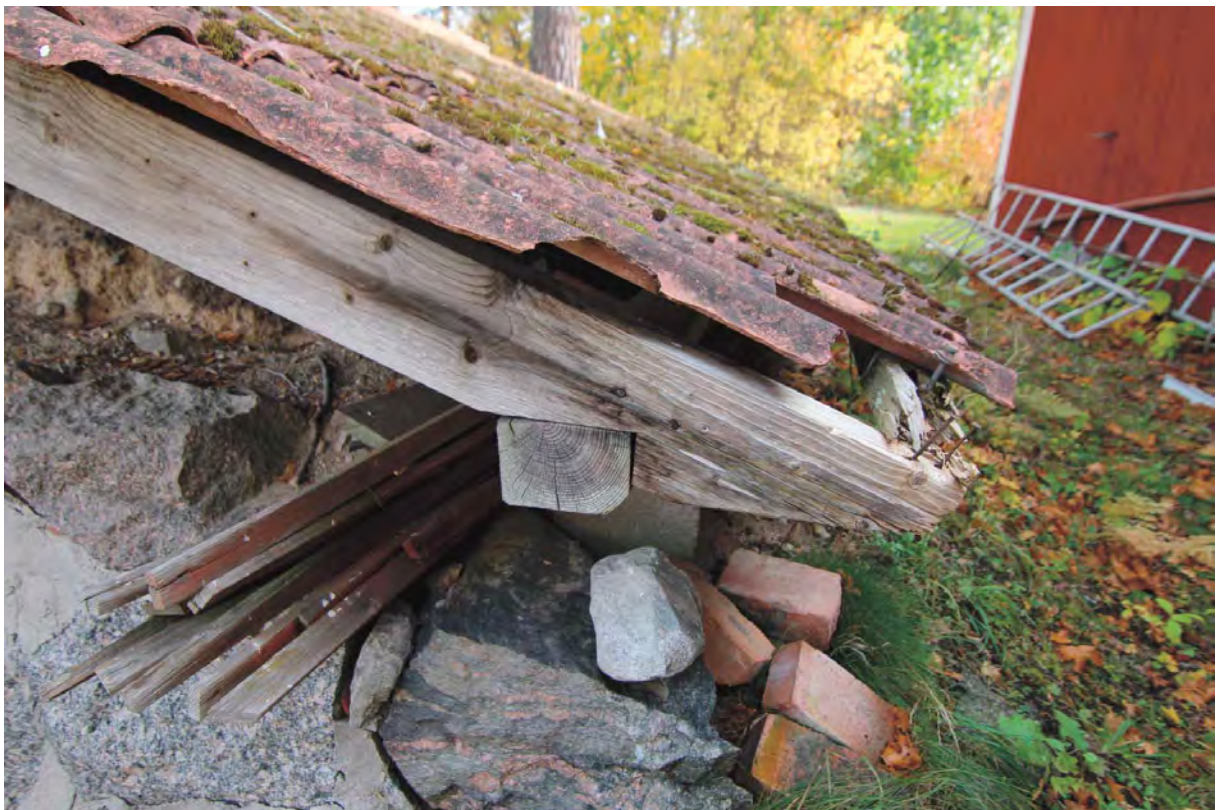
Skadat hörn av taket.
