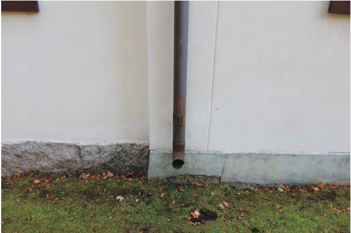
Byggnadsgrunden i nordöst. Till vänster syns sidoflygelns granitgrund och till höger möter den centrala byggnadskroppens utkeragande betonggrund. Putsen släpper där stupröret kastar ut vatten.
