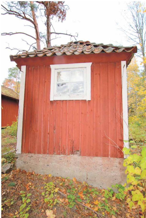
Fasaden mot söder. Viss skada i panel mot grunden.
