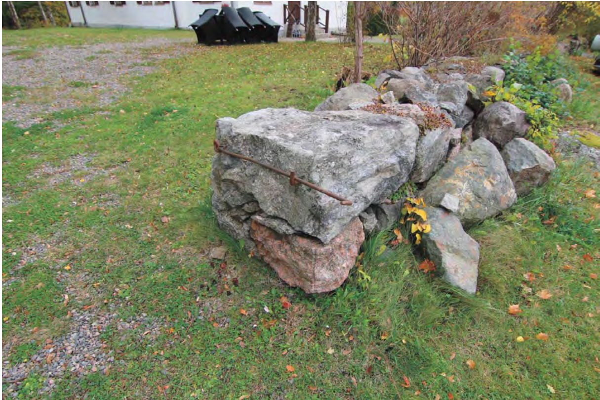
Murens öppning, troligen där man tidigare passerat genom den om man kört via genomfartsvägen. Äldre järnbeslag i stenen för stängning av grind. Grinden saknas.
