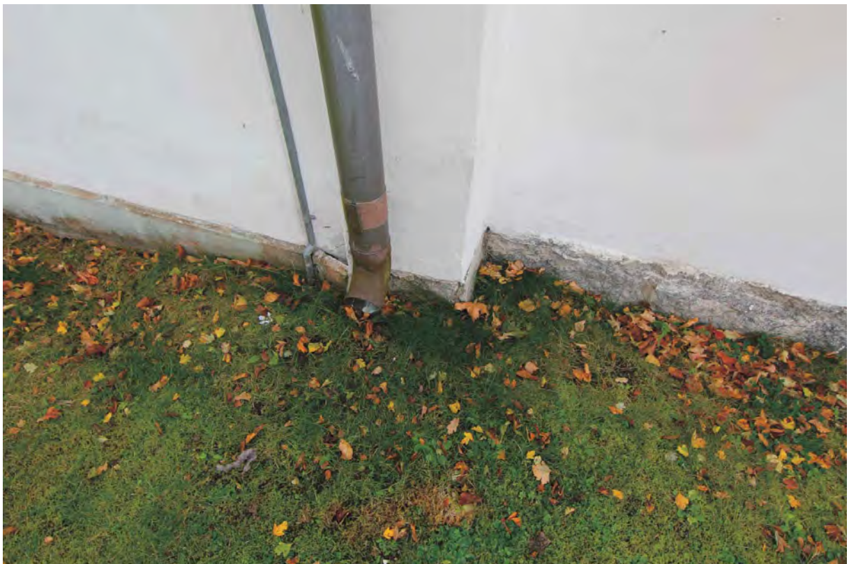
På den nordvästra sidan finns samma problem med avvattningen. Putsad grund släpper där vatten kastas ut.
