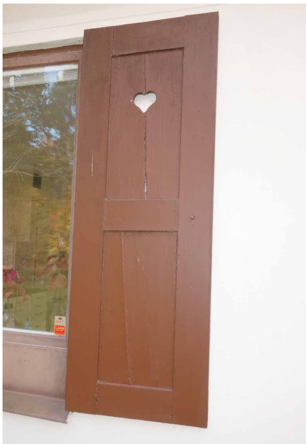
En fönsterlucka där dess konstruktion är tydligt synlig. Sprickbildning har uppstått där fyllningarna fogats samman.
