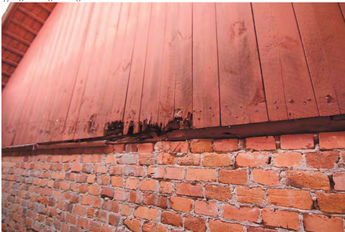
Fasaden mellan ladugården och bönsbuset är inte putsad. Ett droppbleck eller tak har suttit mot träfasaden. fasad och stomme är rötskadad här.
