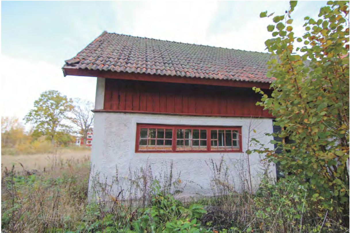
Fasaden mot söder. Murad och spritputsad markplan, panelklätt loft. På taket till vänster syns lös takpanna.
