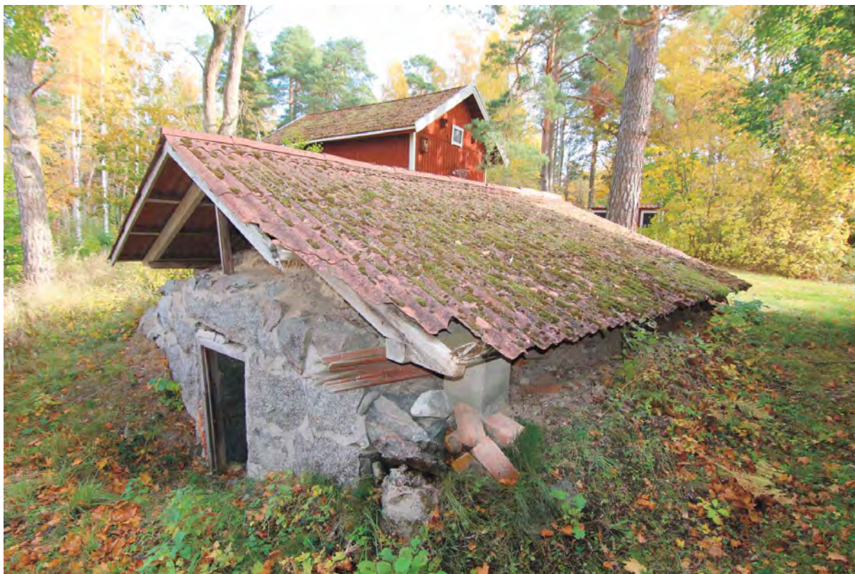
Jordkällaren. Här syns det senare uppförda taket utanpå jordkällaren. Närmst i bild syns det skadade hörnet där eternittaket gått sönder.
