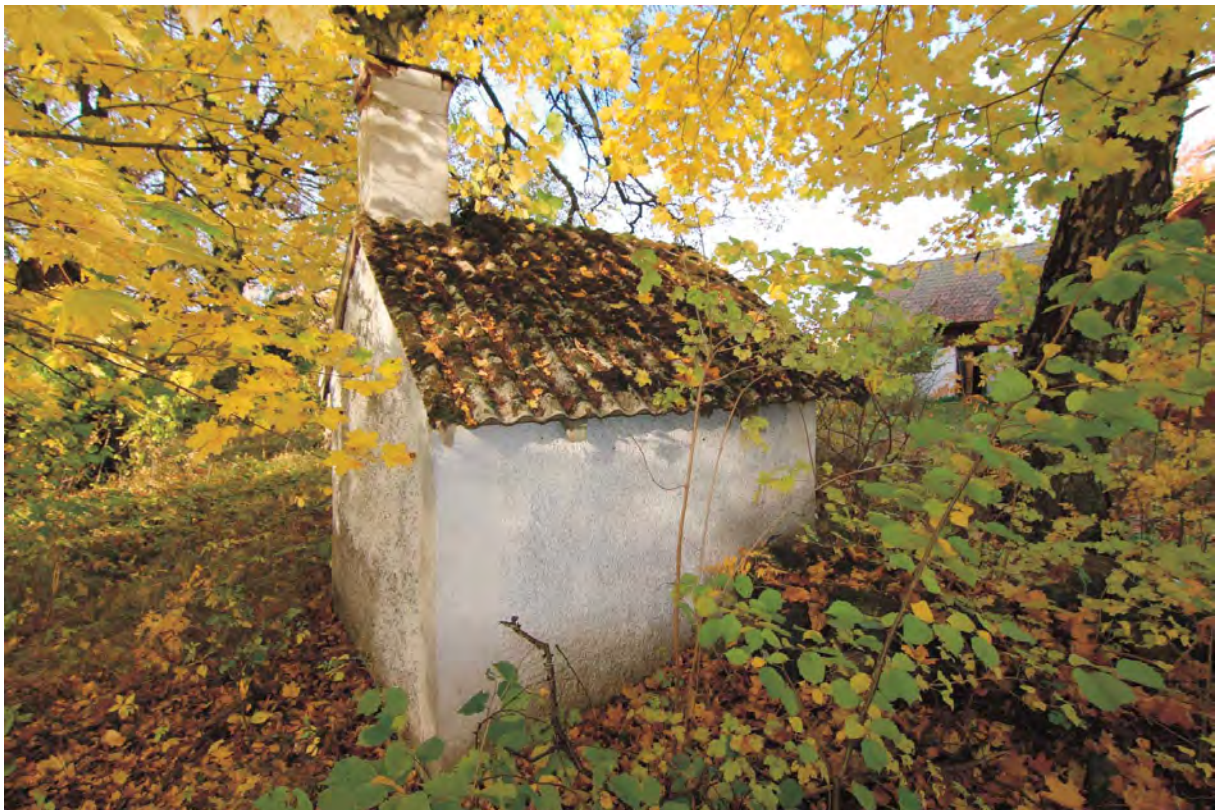
Skorstenen mot söder har vissa putskskador. Mosspåväxt på taket.
