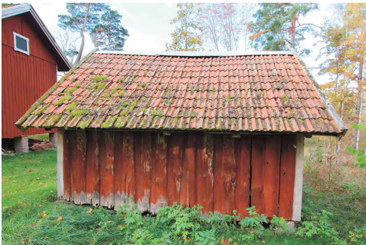
Tegeltak med viss mosspåväxt. Panelen mot öst har avskavd färg men också insektsangrepp.
