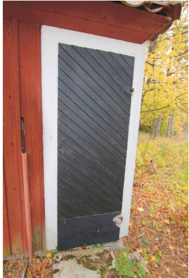
Entrédörr mot söder. Diagonalt orienterad panel, skada i skivmaterial på nedre delen.
