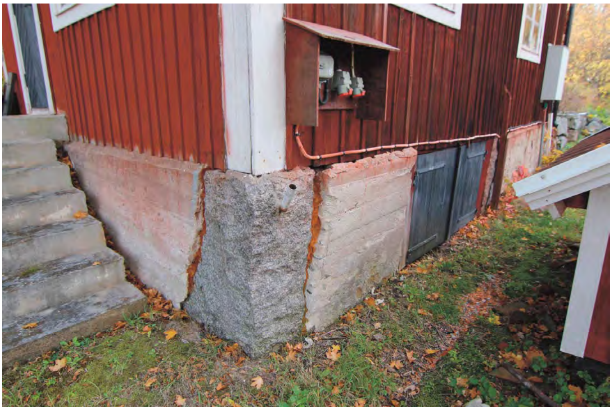
Byggnadsgrunden i nordväst, hörnsten av granit, gjutning av betong som släppt från graniten. Utrymmet i mellan har fyllts ut med fogskaum.
