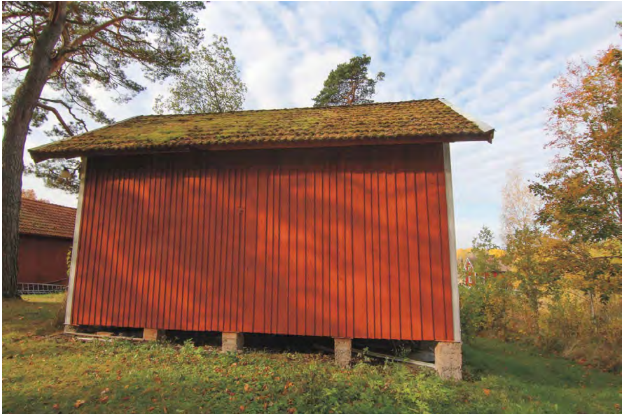
Östra fasaden. Här syns byggnadsgrunden av plintar samt taket som är kraftigt mossbevuxet.
