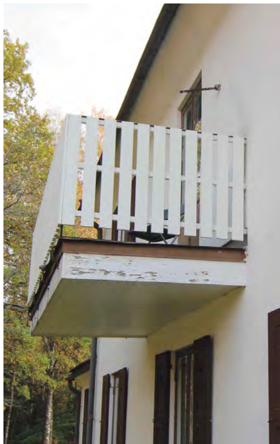
Balkongen i norr med flagnande färg.
