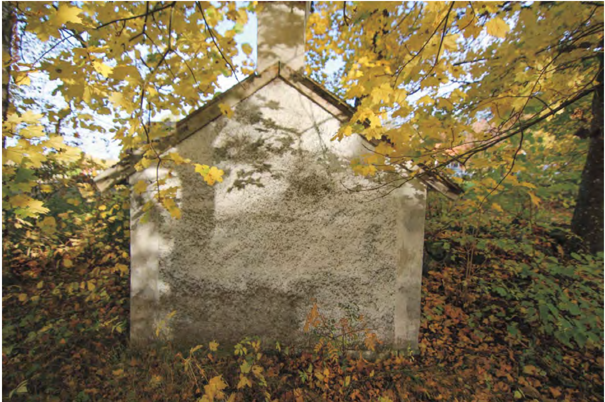
Fasaden mot söder. Spritputsens färg har släppt bitvis.
