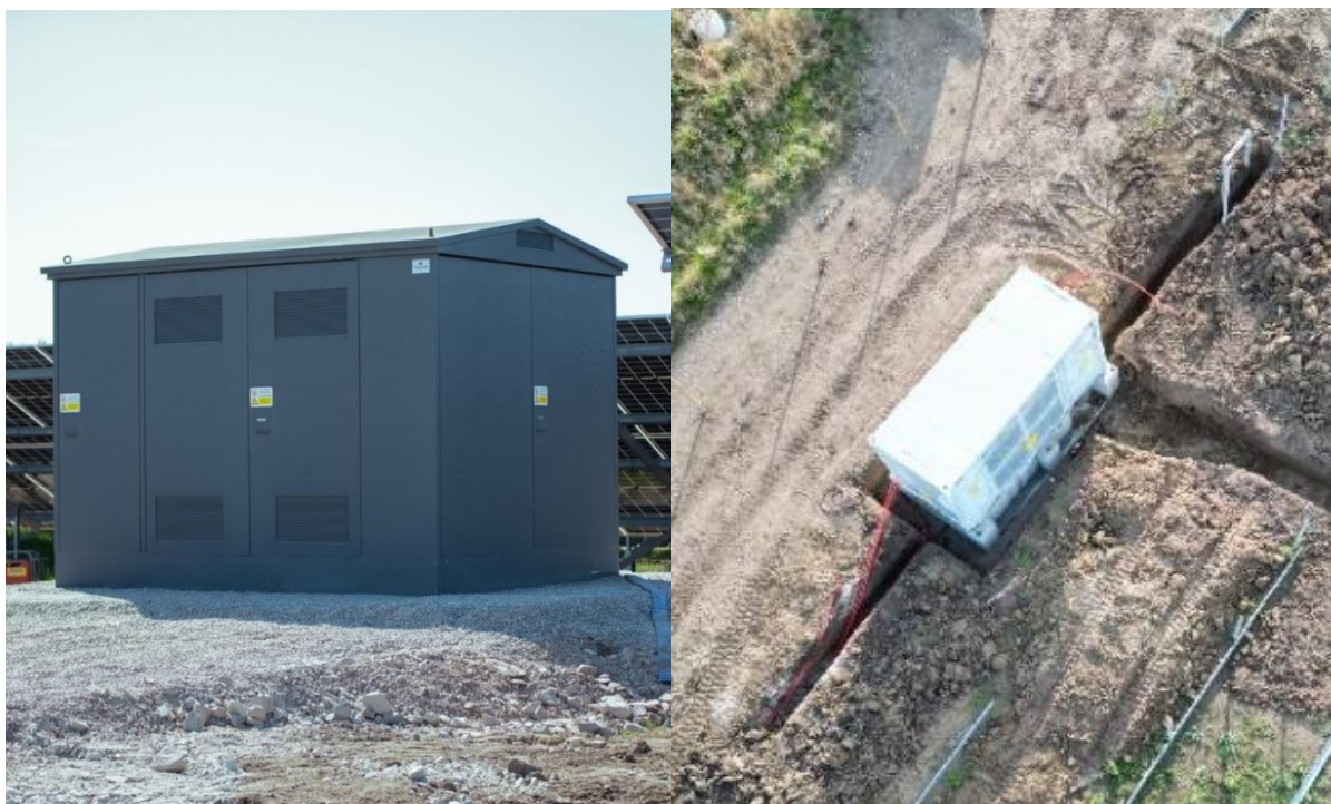
Figur 15. Exempel på transformatorer som kan placeras ut i parken. Vänster: Transformator på avgrusning på markduk i Kungsåra solcellspark utanför Västerås. Höger: Transformator i containerutförande på betongfundament.
