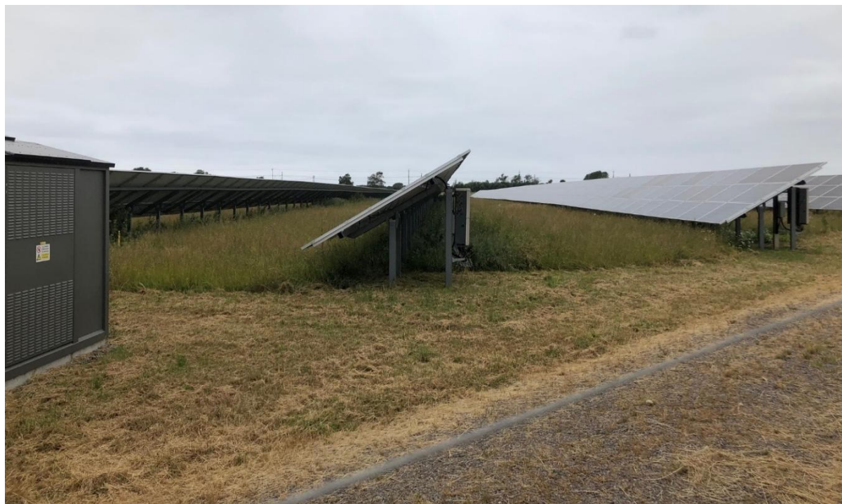
Figur 41. Exempel på synintryck av svensk solcellspark sedd från sydöst. Bild från Varberg Energis solcellspark Solsidan i Tvååker.
