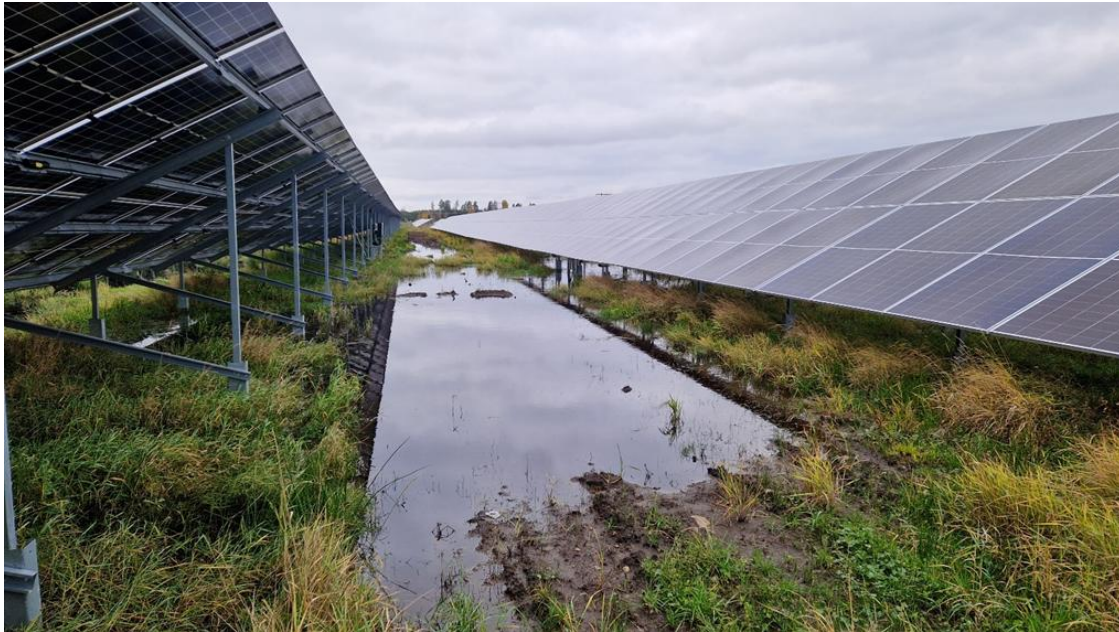
Figur 39. Stående vatten mellan rader av solceller i Kungsåra solcellspark utanför Västerås. Detta är ett år efter byggnation. Att det finns vattensamlingar på vissa platser i solcellsparken bedöms positivt ur naturmiljösynpunkt.
