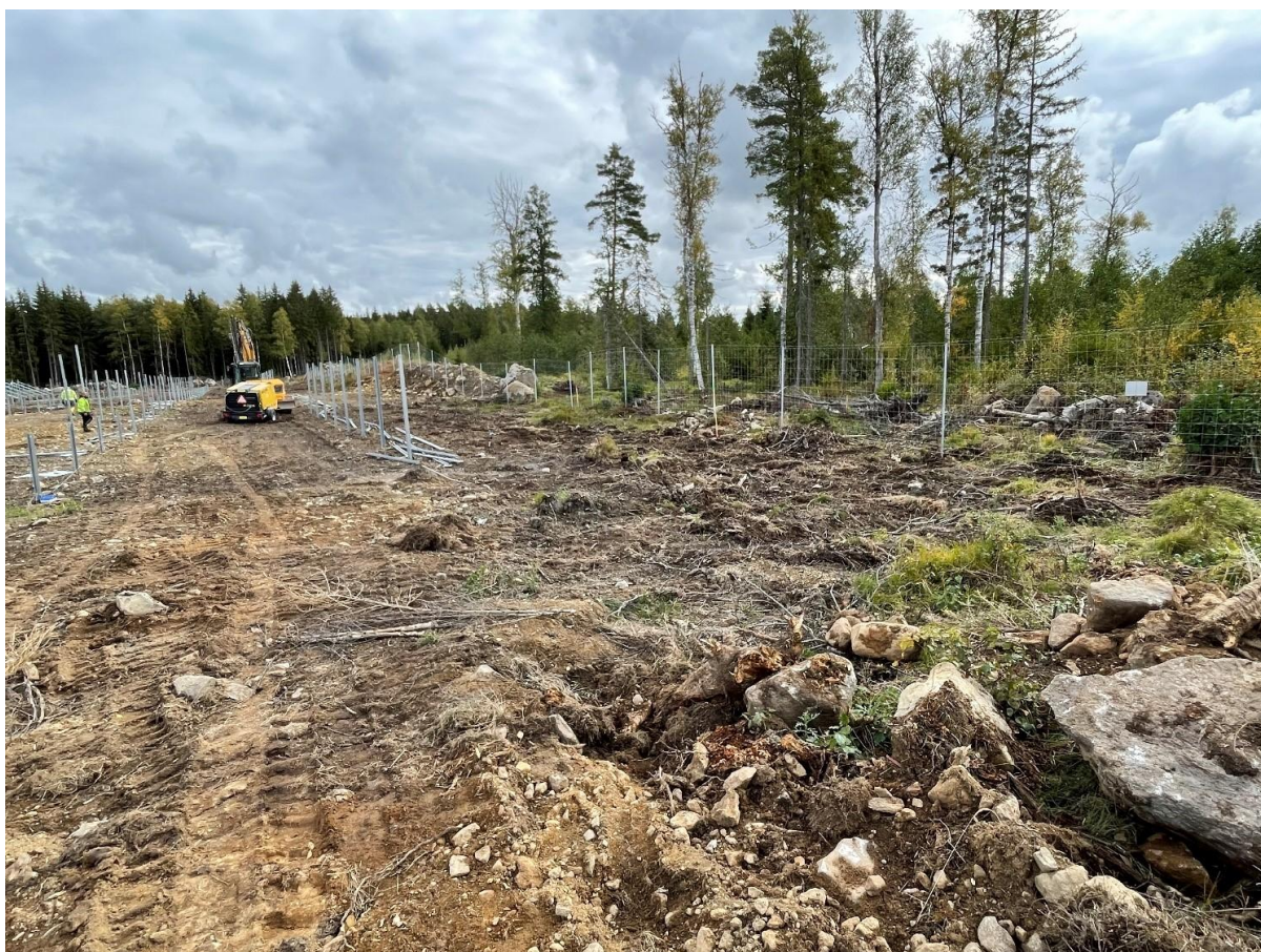
Figur 5. Bild från Kungsåra solcellspark utanför Västerås under byggnation. Parken är delvis uppförd på skogsmark. Arbete med markställningar pågår.
