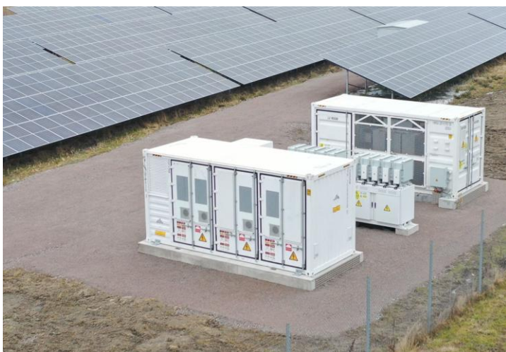
Figur 18. Exempel på samlokalisering av solceller och batterilager.
