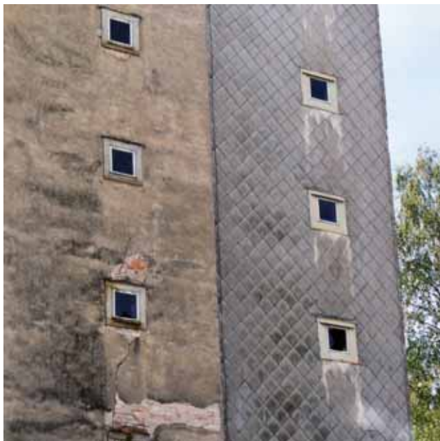
Spannmålslagerhusets fasad är omväxlande putsad och inklädd med eternitplattor. Byggnaden är tyvärr i stort behov av underhåll
