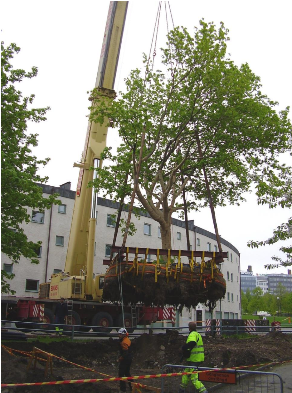
Figur 3. Lönnen på bilden flyttades i samband med byggandet av Norra länken i Stockholm. Trädet är i dag vid god vitalitet och klarade därmed flytten bra.
